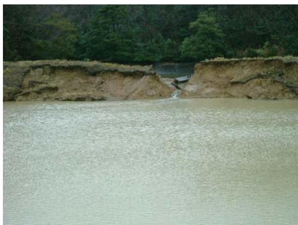
ため池堤体の決壊（平田池、志賀町）
